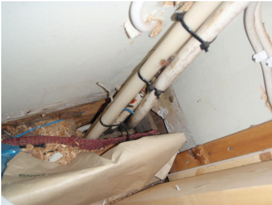
Läpiviennit eivät täytä nykymääräyksiä.
