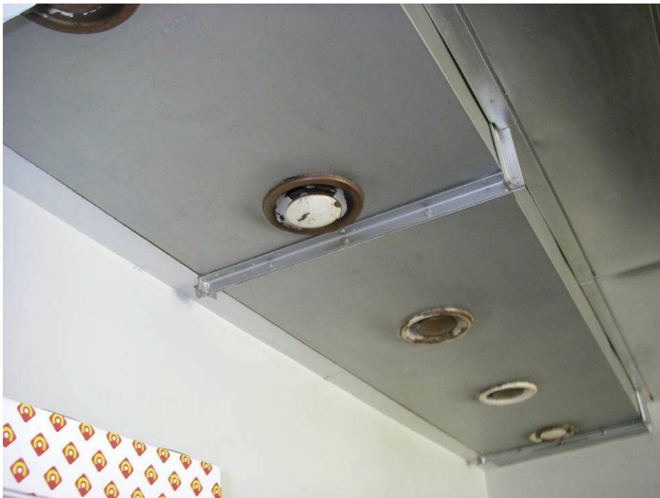
Keittiön poistokanavaa ja venttiileitä.
