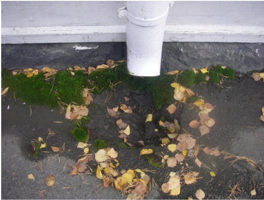
Kattovedet johdetaan syöksytorvilla alas katolta
