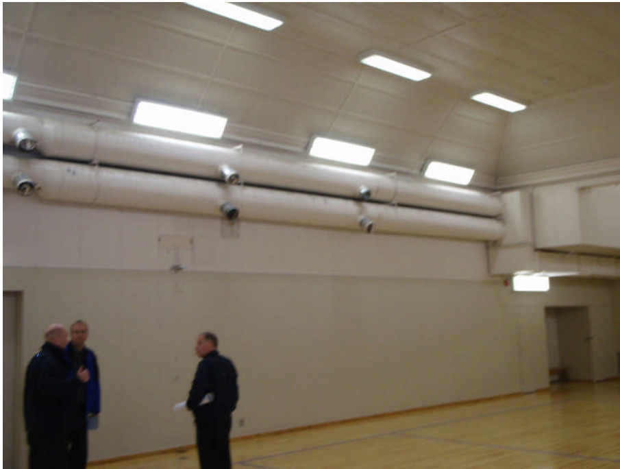
Liikuntasalin valaistus on toteutettu loisteputkivalaisimin. Valaistus on kyseiseen tilaan riittävällä tasolla.
