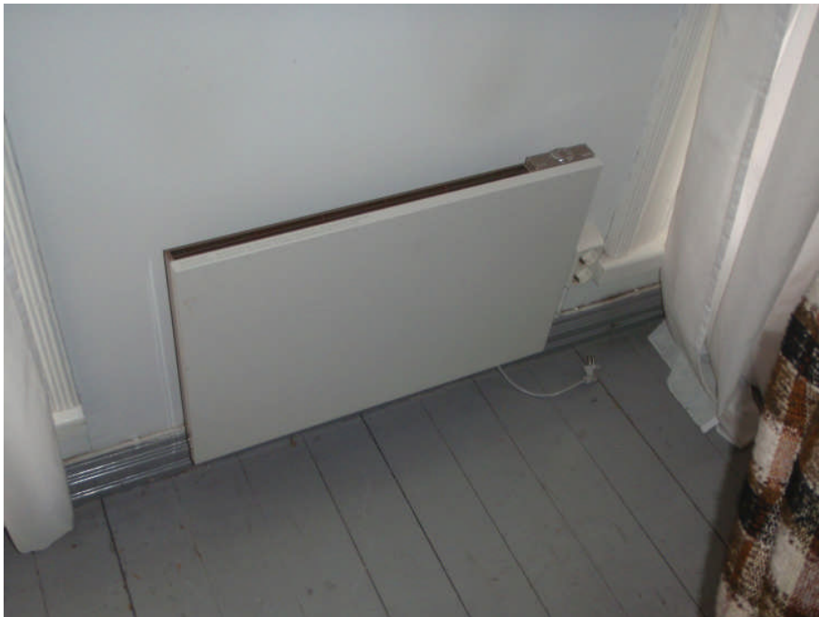
Majoitustiloihin on asennettu pistorasiatulppa liitännäisiä sähköpattereita.
