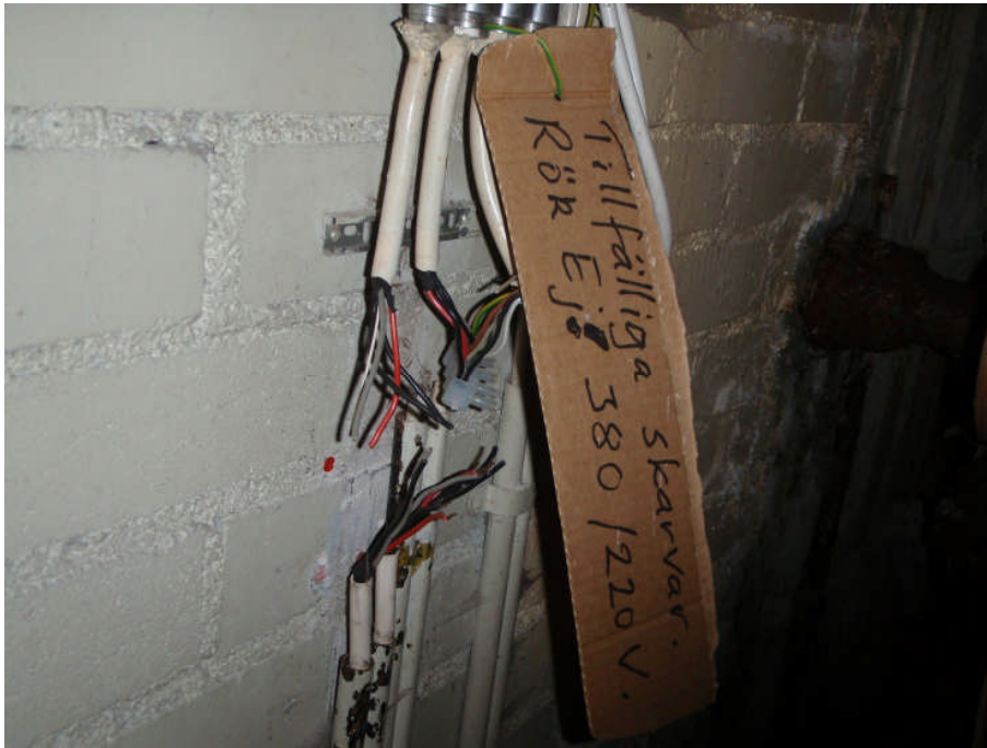
Kiinteistössä havaittiin päättämättömiä ryhmäjohtoja.
