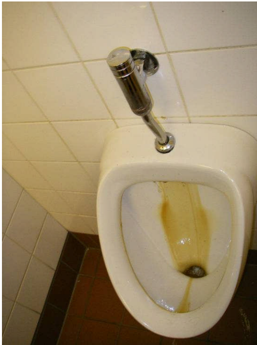
Tarkastuskierroksella havaittiin myös vuotavia wc kulhoja ja pisuaari (kuvassa).
