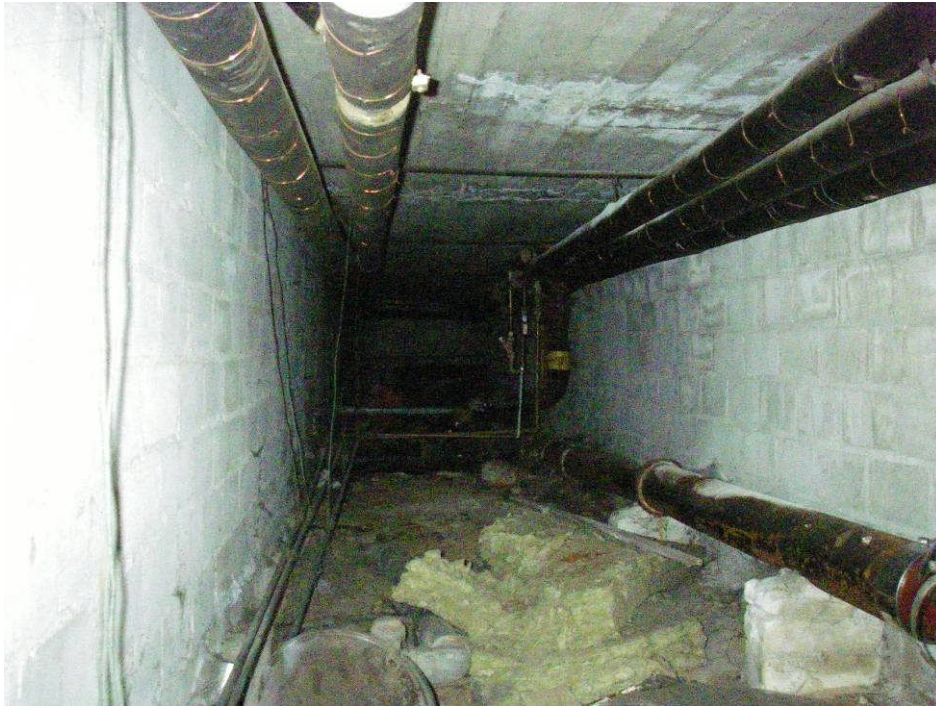
Putket kulkevat ainakin osin alapohjatilassa putkitunnelissa, joten niiden kunnon tutkiminen on mahdollista.
