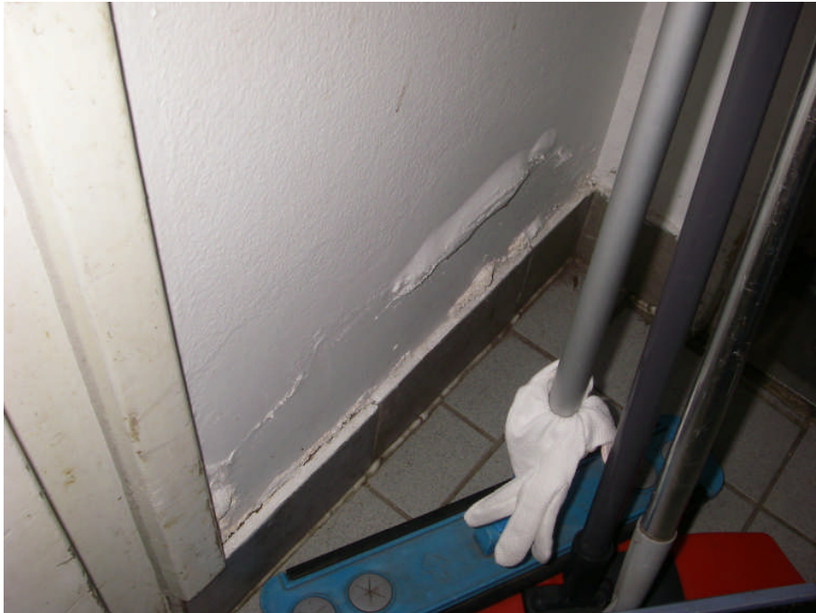
Keittiön edessä olevan käytävän seinän pinnoite irtoilee
