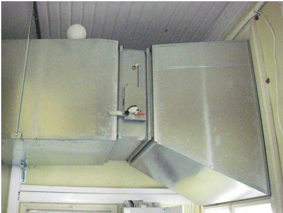
Jumppasalin ilmanvaihtokoneeseen on noin viisi vuotta sitten siihen lisätty raittiin ilman otto, jolloin ilmaa voidaan joko kierrättää tai puhaltaa raitista ilmaa.
