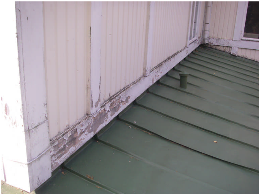
Julkisivuilla korjausta vaativia kohtia puuverhoilussa
