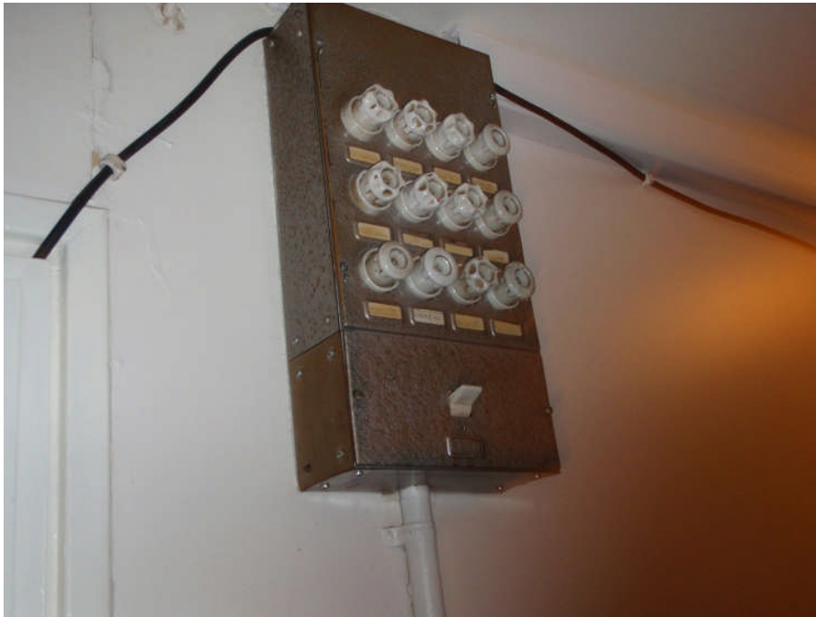
Kiinteistön ryhmäkeskukset ovat peräisin usealta eri vuosikymmeneltä.
