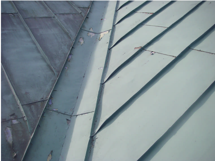
Vesikatteen maalipinta irtoile paikoin
