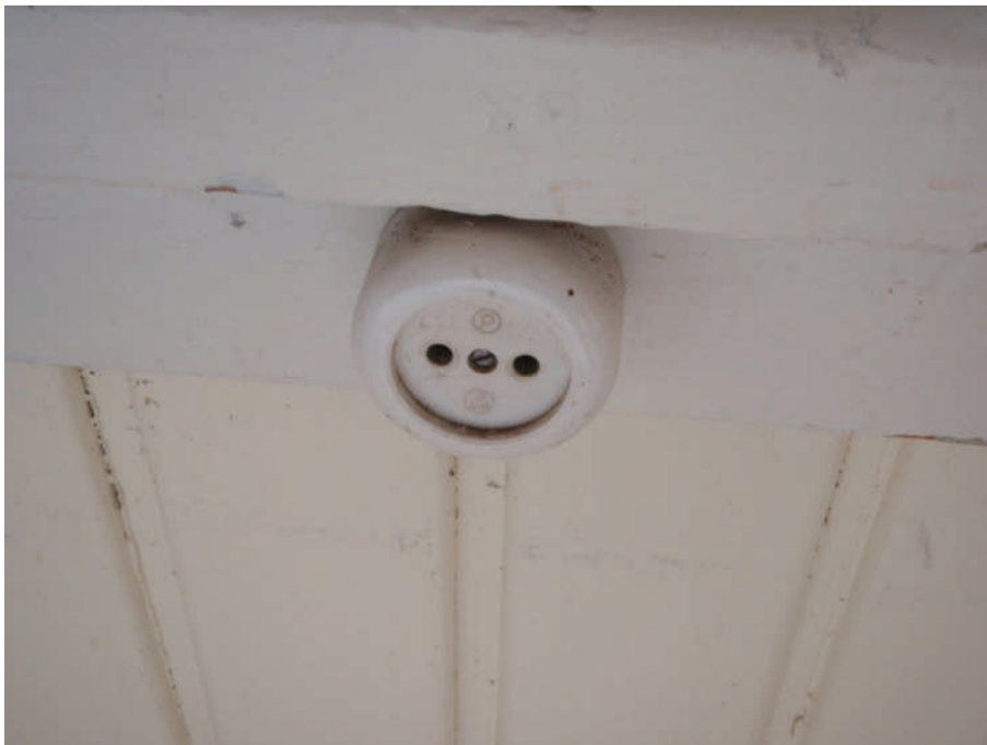
Sähkökalusteet ovat peräisin usealta eri vuosikymmeneltä.
