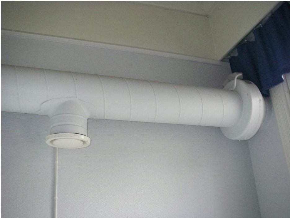
90 luvulla uusituissa wc ja sosiaalitiloissa havaittiin myös saman ikäinen kanavapuhallin.
