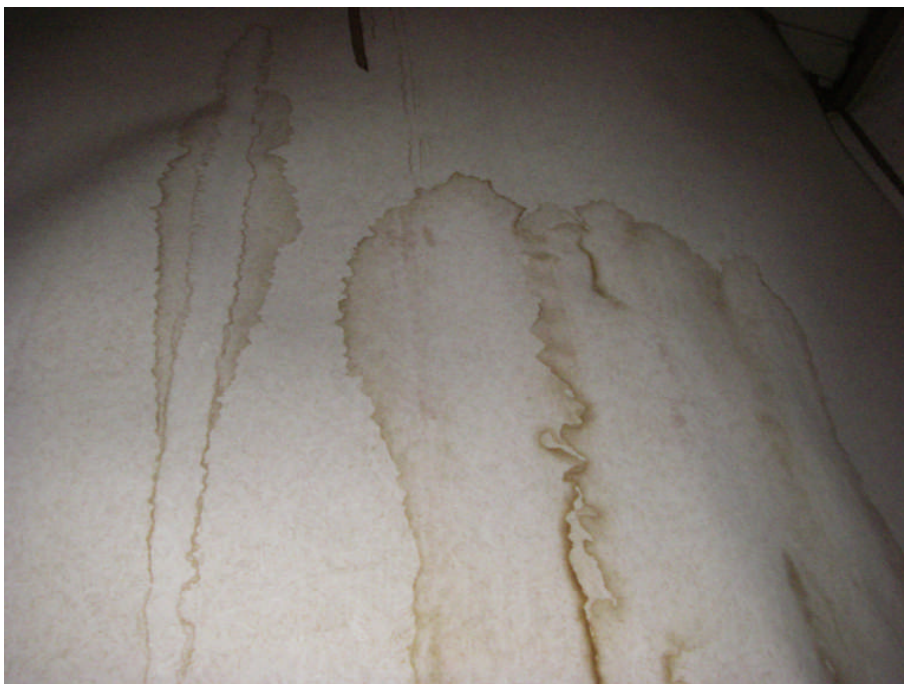
Vaatehuonetta, jossa kuivuneita kosteusjälkiä
