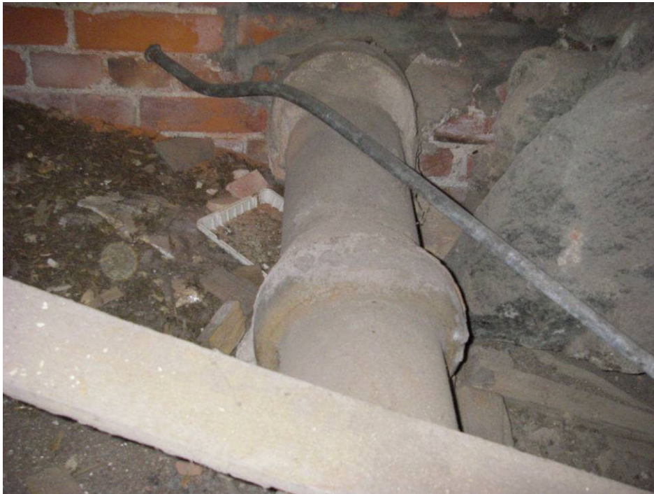
Viemärimateriaalina on aikaisemmin käytetty betonia.
