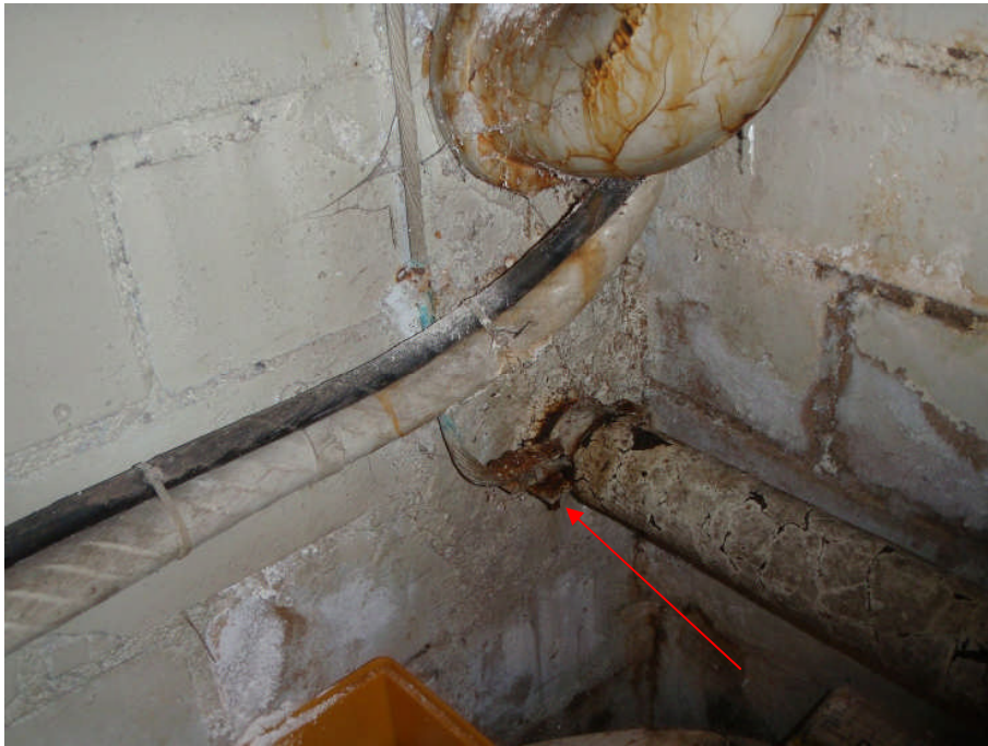
Putkistomaadoituksia. Johtimissa havaittiin korroosiota.
