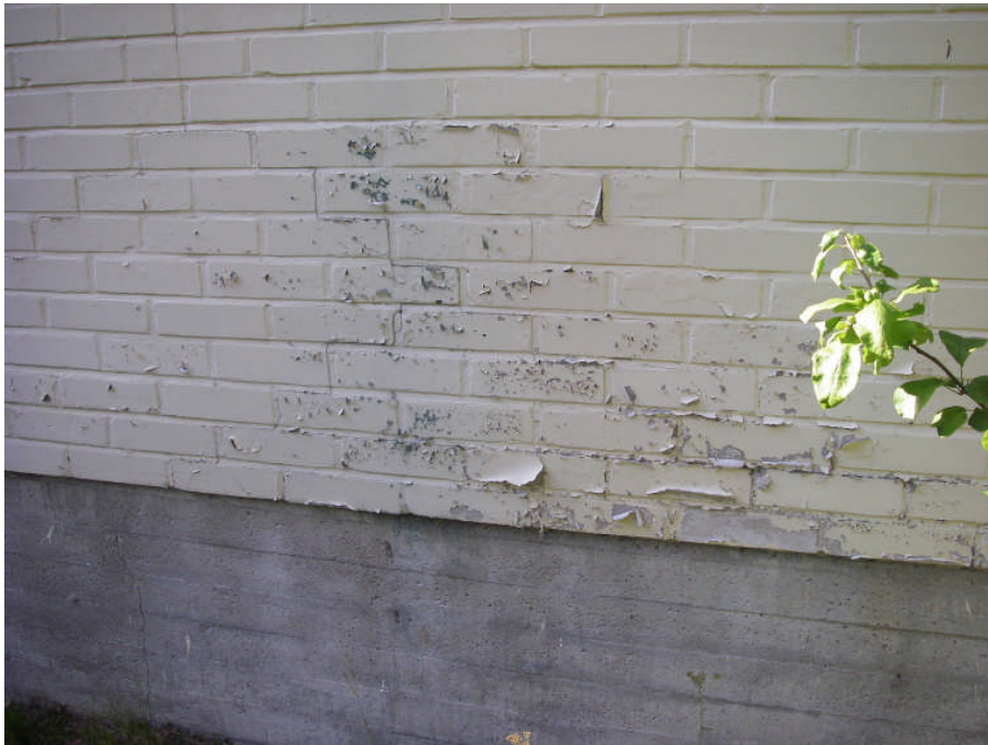
Keittiön kohdalla tiiliseinässä pinnoite irtoilee
