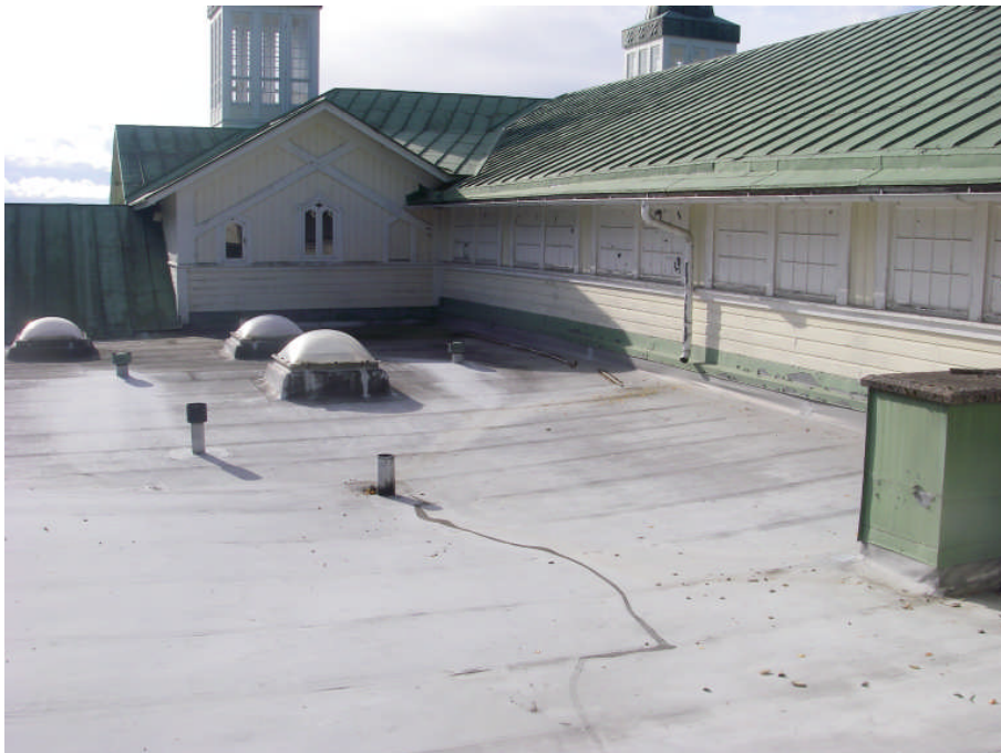
Tasakatto osa, joka vaatii korjausta
