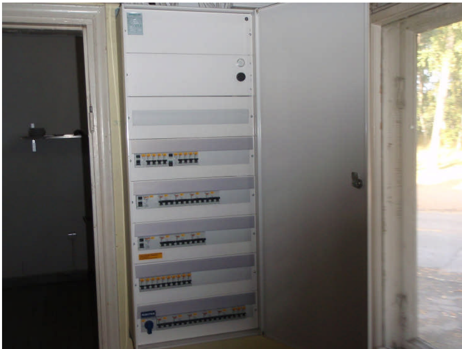
Kiinteistön ryhmäkeskukset ovat peräisin usealta eri vuosikymmeneltä.
