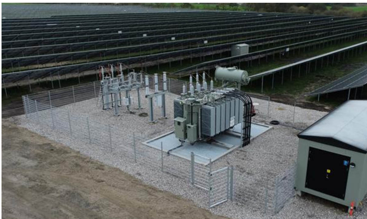
Exempelbild på ett transformatorområde.
