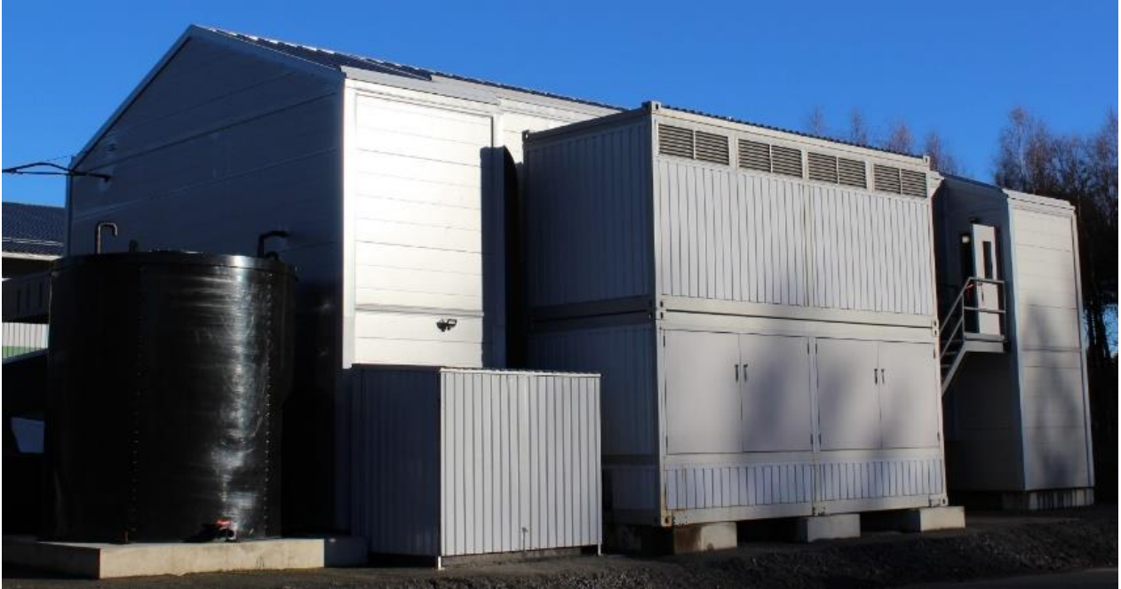
Kuva: ReGreenMix-moduulikompostori Hangon Jäteasemalla
