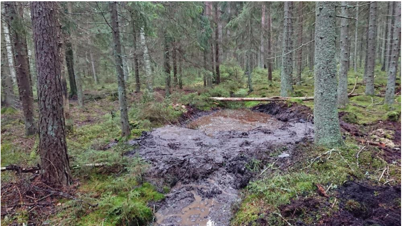
Kuva 11. Esimerkki pienestä kaivinkoneella tehdystä padosta ojassa, jossa ei ole penkkamaita täyttöön. Yleensä padosta kannattaa varmuuden vuoksi tehdä tätä suurempi.
